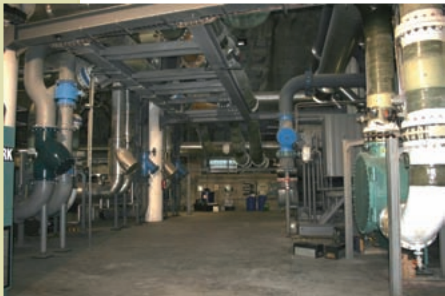
Interior de una central de redes de calor.
